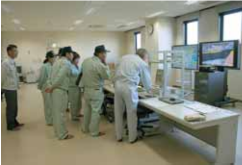
押分排水機場(岩沼市)
