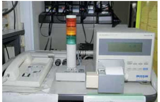
庁舎2階に設置されているJアラート
