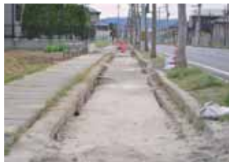
陥没した歩道(清住町)
