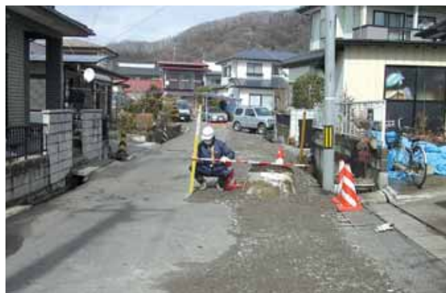
大きく隆起したマンホール(清住町)
