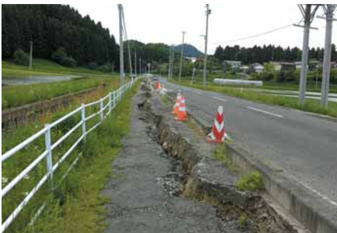
通学路にも大きな被害が(町道船迫14号線)
