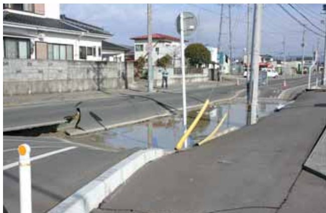
仙南・仙塩広域水道の送水管に被害(大沼通線)
