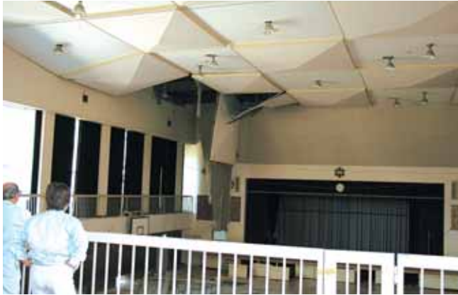
船迫小学校の被害(写真は議員の被害調査)
