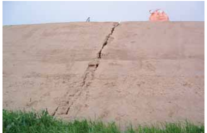
雨が降って堤防に雨裂(阿武隈川堤防)
