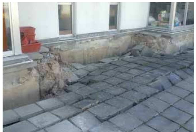
地盤沈下した槻木小学校
