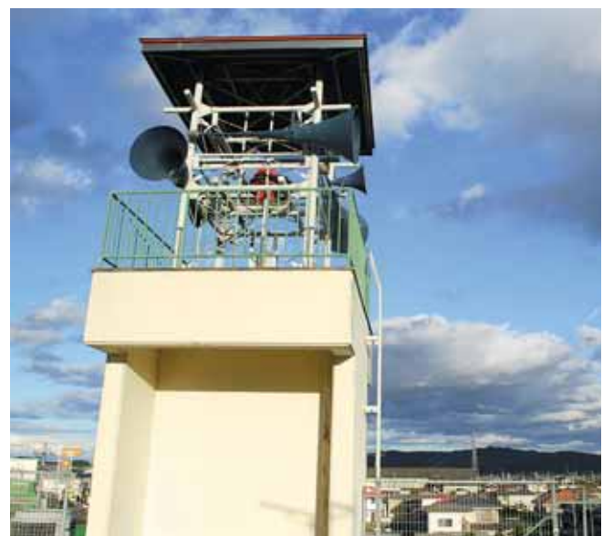
柴田消防署の放送設備
