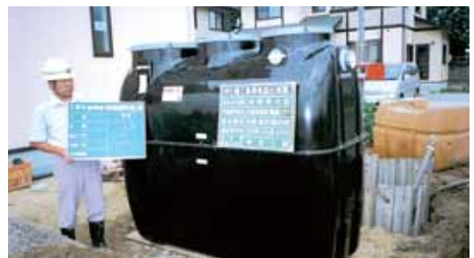
合併処理浄化槽
