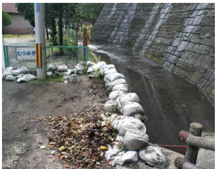
水害の跡が残るむつみ学園脇の排水路
