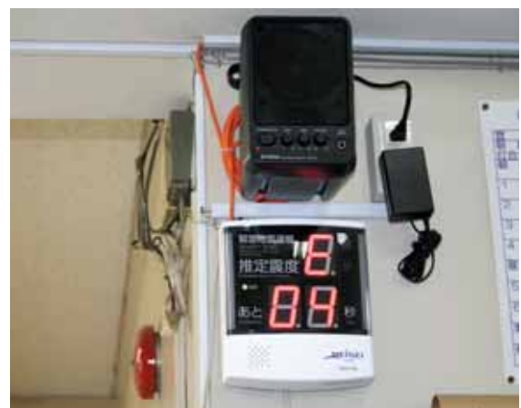
船岡中学校に設置した緊急地震速報システム
