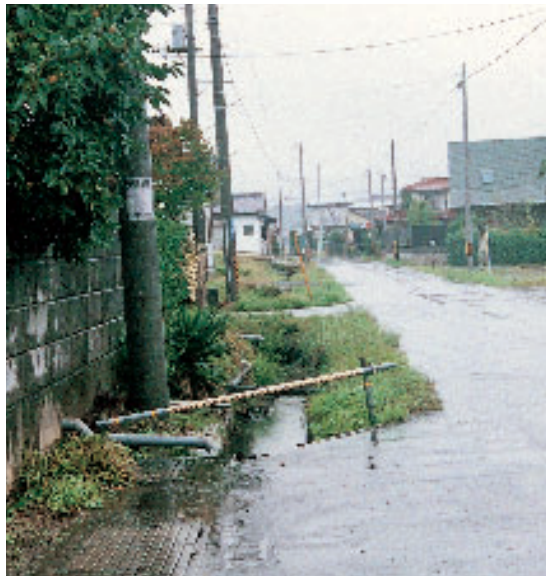
整備が必要な側溝
