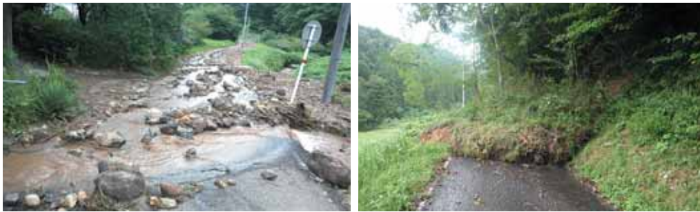
9月の豪雨で被害のあった町道葉坂3号線（葉坂字音見坂付近）
