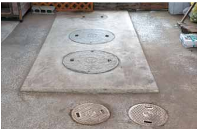
定期的な保守点検を必要とする合併処理浄化槽
