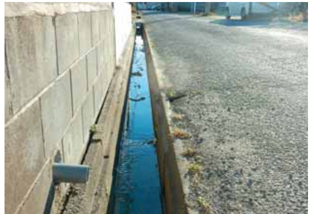
蓋もなく排水が滞留している側溝
