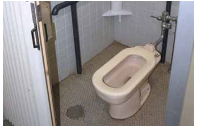
利用しにくいトイレ（役場庁舎1階）
