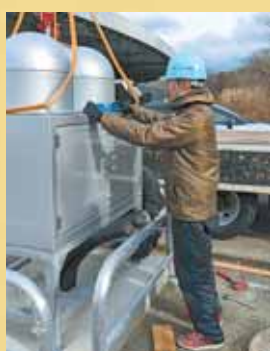
モニタリングポストの設置確認をする安藤さん。
