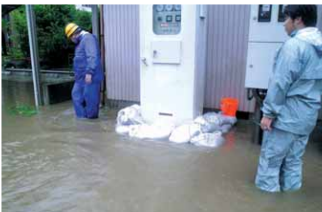
頻繁に冠水する道路(船岡西2丁目)
